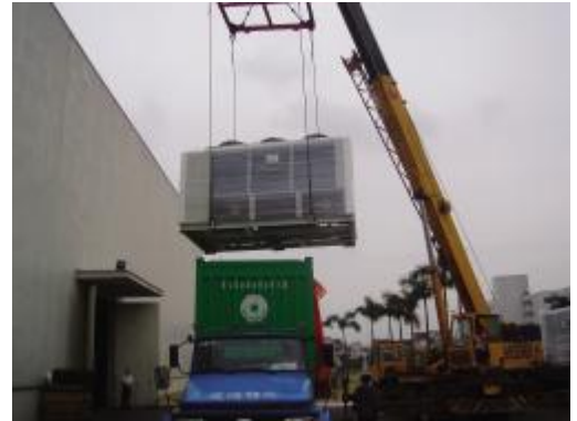
▲准备发运到突尼斯的格力大型中央空调
